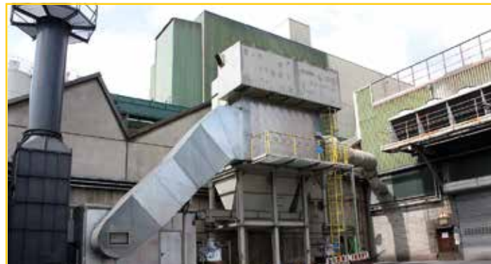
▲ Eine neue Luftfilteranlage wird die Luftemissionen weiter reduzieren.
