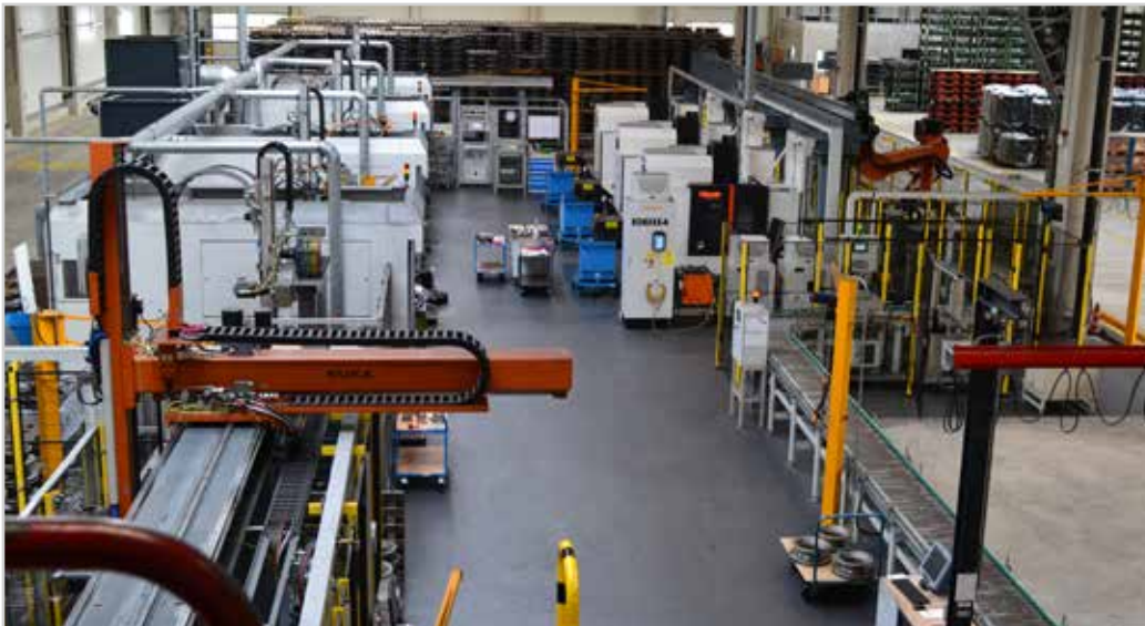
▲ Neue Fertigungslinie zur Bearbeitung von LKW-Bremscheiben in Halle 7, Werk Bestwig
